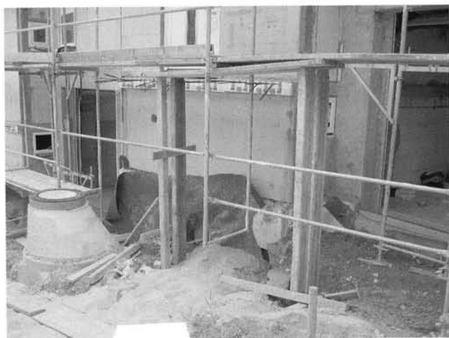
Abb. 4: Fehlgeschlagene oder mangelnde Koordination: unzulässige Gerüstveränderungen wegen notwendiger Herstellung von Leitungsanschlüssen.
